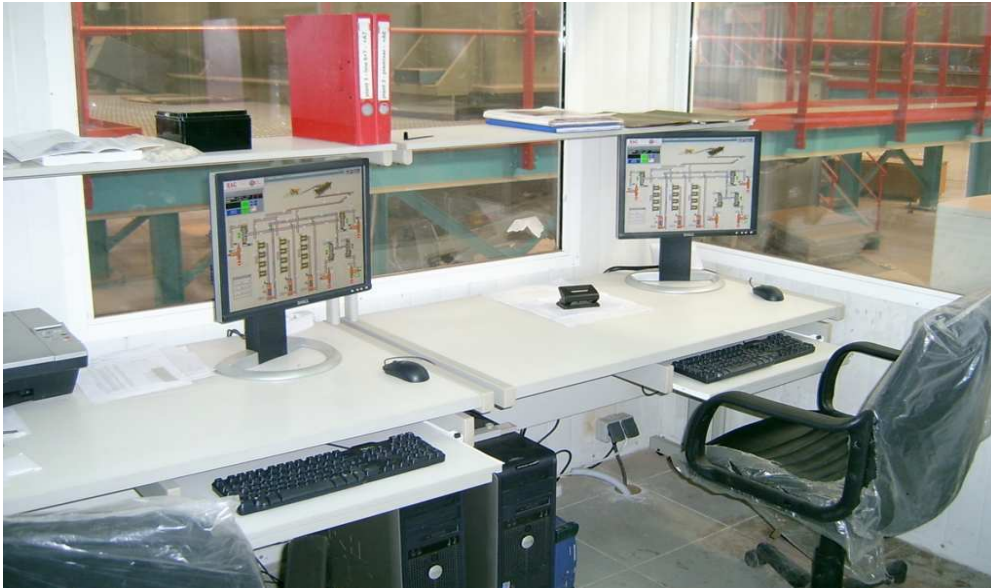
Desktop PC Systeme als Operator Kontroll- und Bedienplatz
